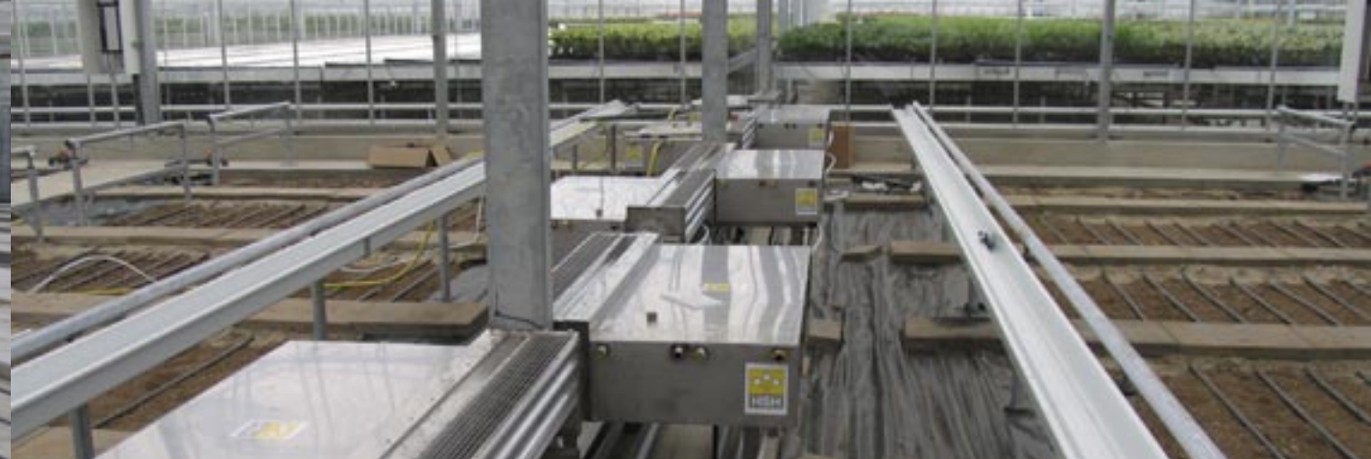
Inrichting pilot Energieproducerende Kas
